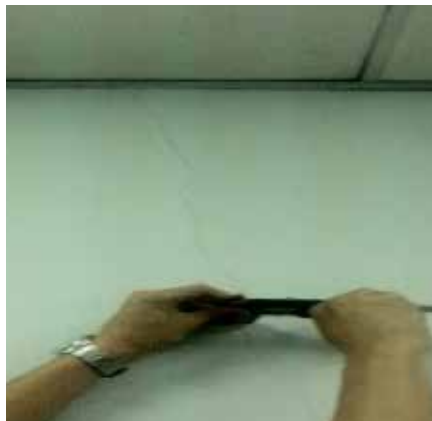
Foto 1.5: Keadaan struktur dinding bangunan yang retak dan lembap serta keadaan cat mengelupas
