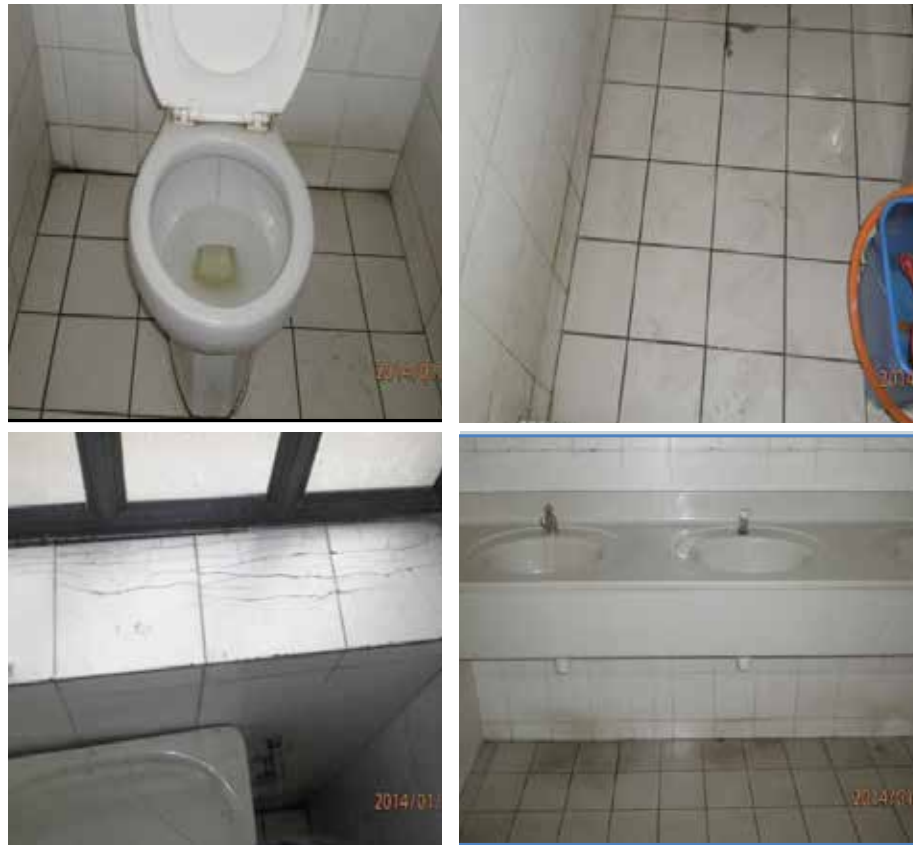
Foto 1.2: Kelengkapan sanitari yang usang dan kotor
