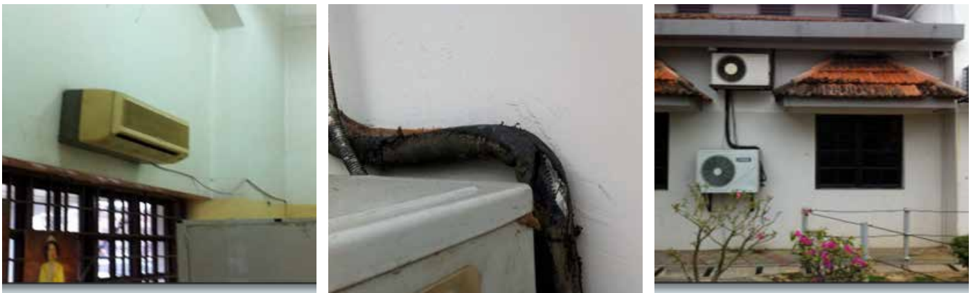
Foto 1.8: Keadaan system pendawaian untuk penghawa dingin yang lama dan tidak diselenggara dengan baik
