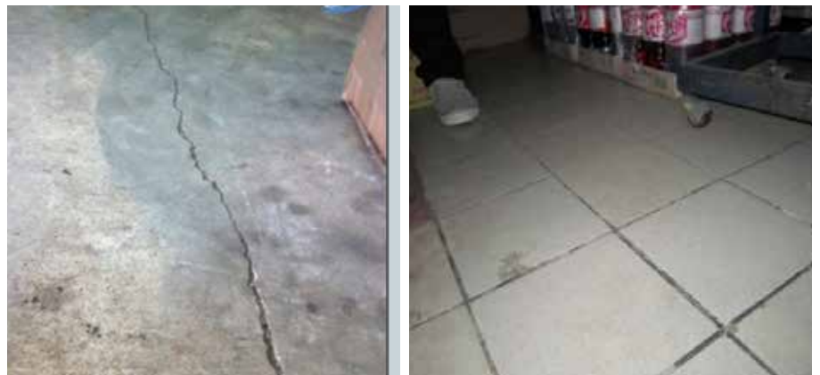
Foto 1.3: Lepaan lantai yang retak dan kemasannya yang usang berdasarkan kemungkinan tiada penyenggaraan berjadual
