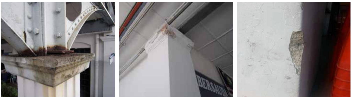
Foto 1.4: Keadaan struktur tiang yang berkarat dan usang serta keadaan tiang konkrit yang retak
