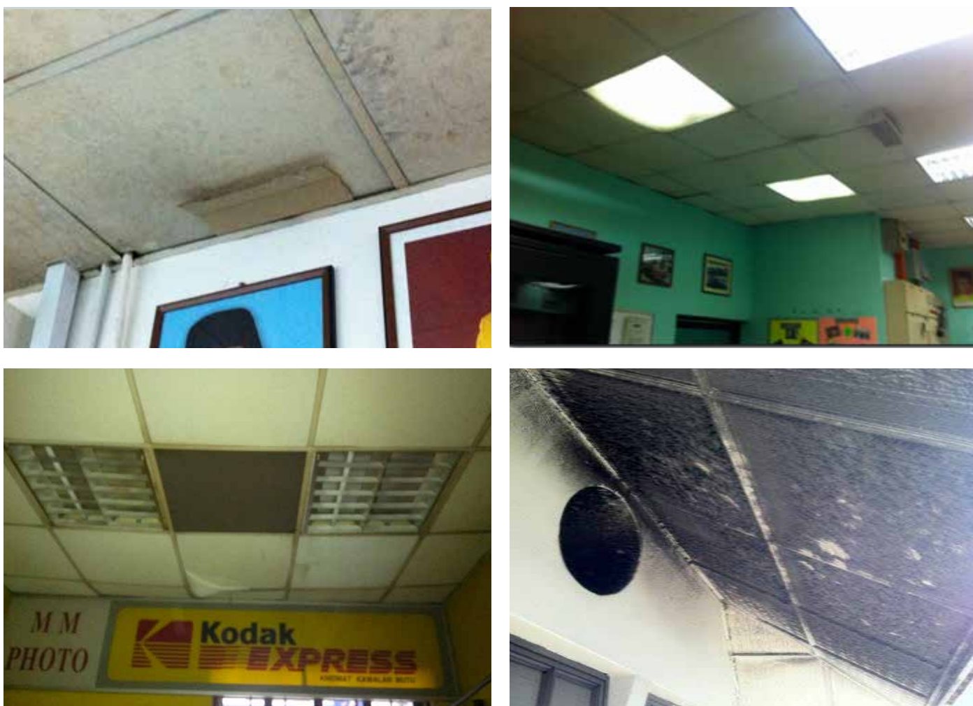
➤ Foto 1.1: 'Suspended ceiling' yang melendut dan pemasangan yang tidak mengikut spesifikasi serta keadaan siling yang kotor
