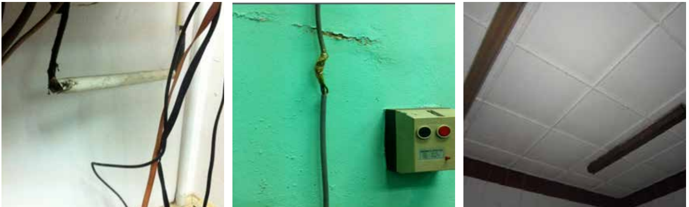
Foto 1.8: Keadaan system pendawaian elektrik yang lama dan tidak mengikut spesifikasi
