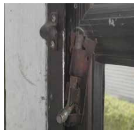
Foto 1.7: Keadaan tingkap yang tidak berfungsi dan ditutupi oleh kotak mendatangkan risiko jika berlaku kebakaran dan keadaan elemen tingkap yang using dan berkarat
